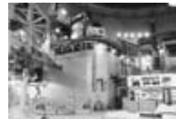
原子炉格納容器内 温態機能試験(昇温昇圧中)状況
